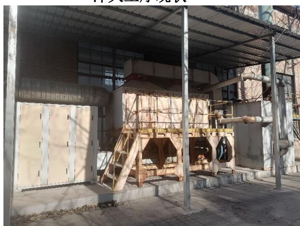
刷漆房废气处理装置现状（利旧）
