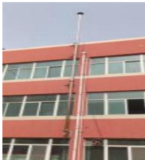
推板电窑排放口
