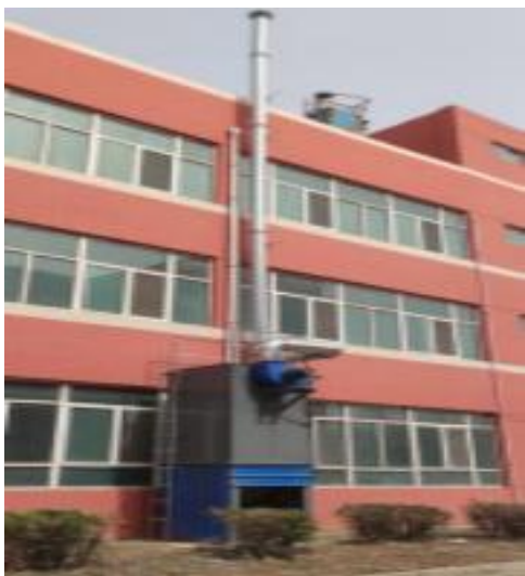
搅拌除尘器及排放口
